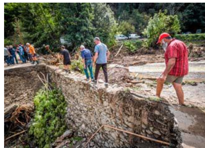
La route d'accès au hameau et le parapet se sont effondrés.
